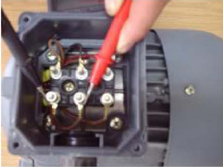
Resim 1.12: Fazlar arası kısa devre kontrolü
