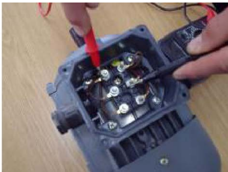
Resim 1.30: Motor faz sargılarının kontrolü
